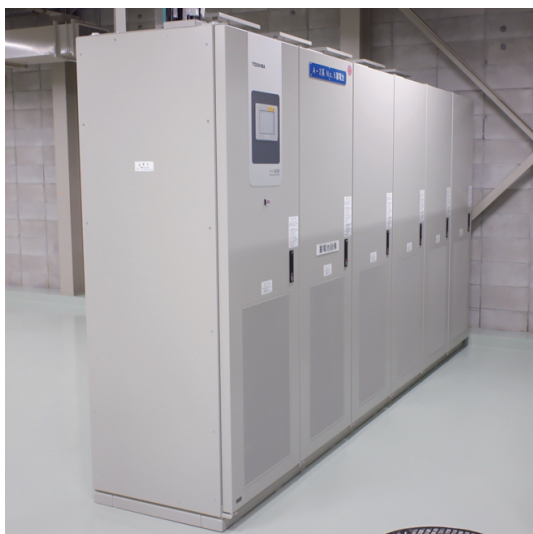
写真1 某大手金融機関のデータセンターに導入されたSCiB™を使用したUPSシステム
