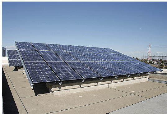
写真3 屋上に設置された太陽光発電パネル
