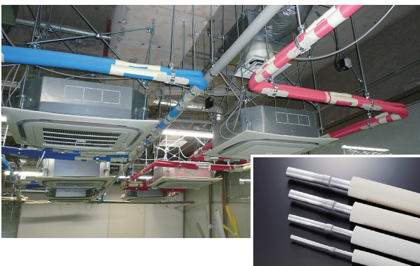
図1 アルミ冷媒配管による実機検証事例
