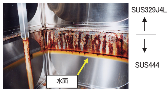
写真2 ステンレス製受水槽の腐食（2年半使用）
