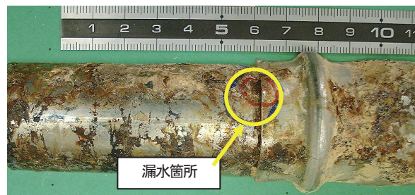
写真5 ステンレス鋼管 (SUS304) の外面からの応力腐食割れ
