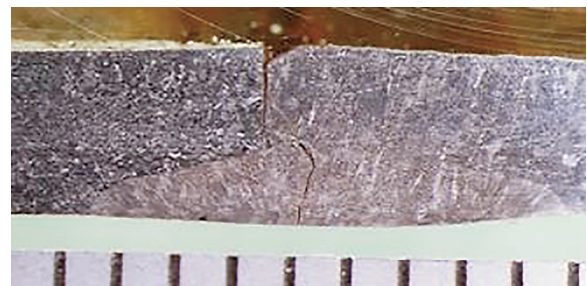
写真4 ステンレス鋼管 (SUS304) 溶接部の割れ (5年使用、溶接不良を引き起こしている)
