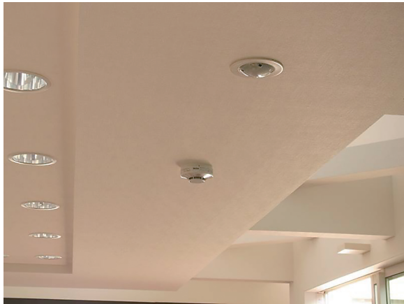
写真2 室内環境センサー（天井）
