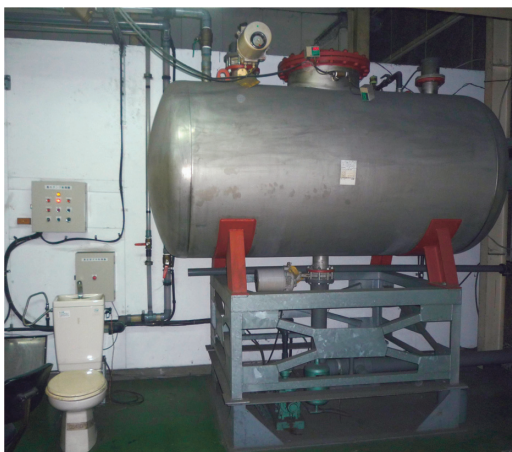
図4 真空集水タンク
