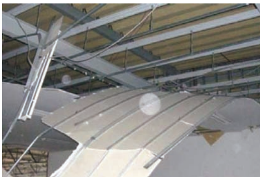
クリップの外れによる天井落下
