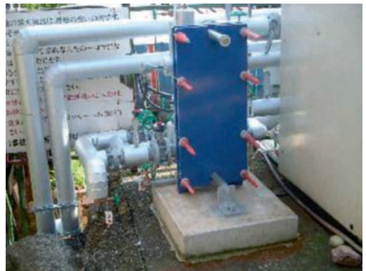
熱交換器の外観
